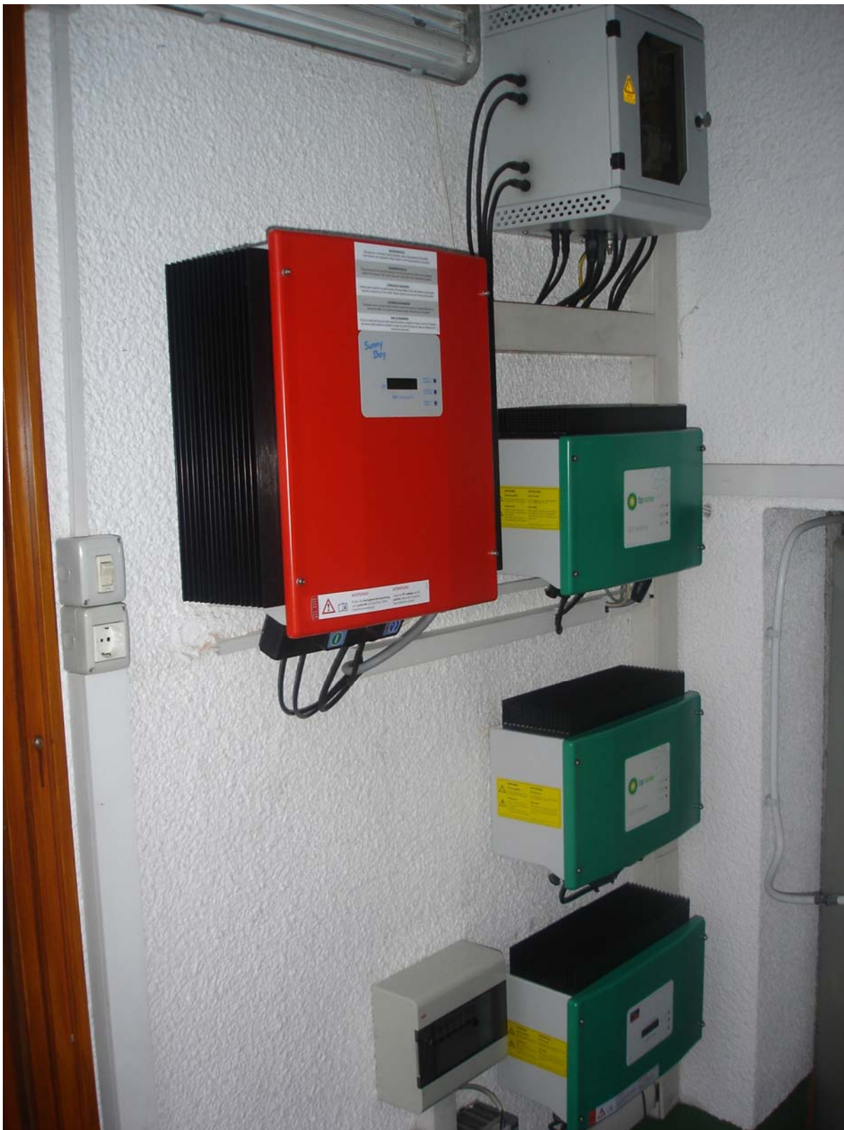
Razdjelni ormarić solarnih modula i izmjenjivači dc/ac
