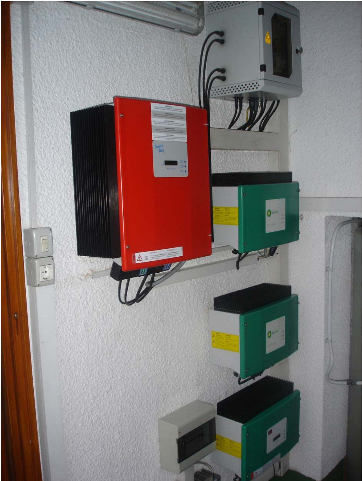
Razdjelni ormarić solarnih modula i izmjenjivači dc/ac
